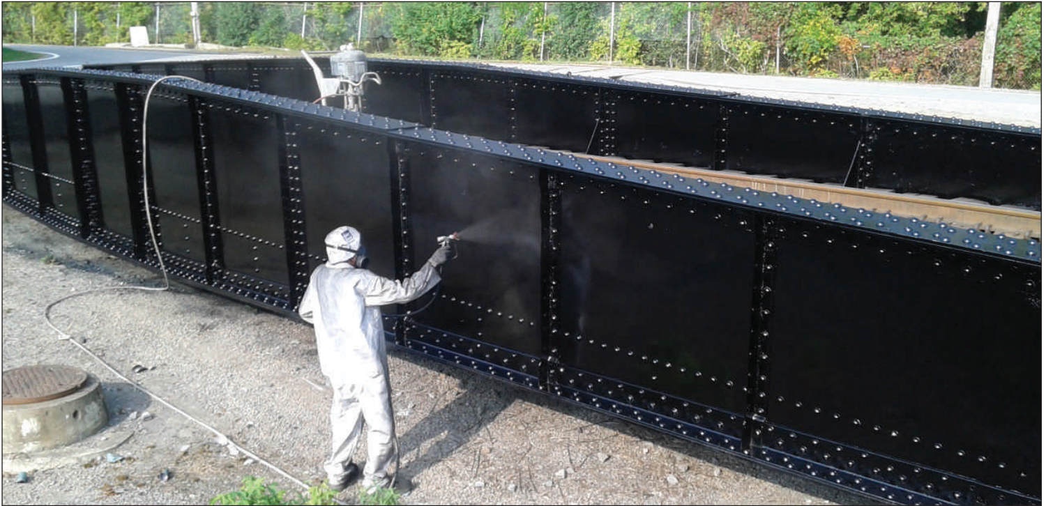
In preparation for the Diesel Weekend even our turntable received a new coat of paint for the event! Notre pont tournant recevant une nouvelle couche de peinture en prévision du week-end diesel!
